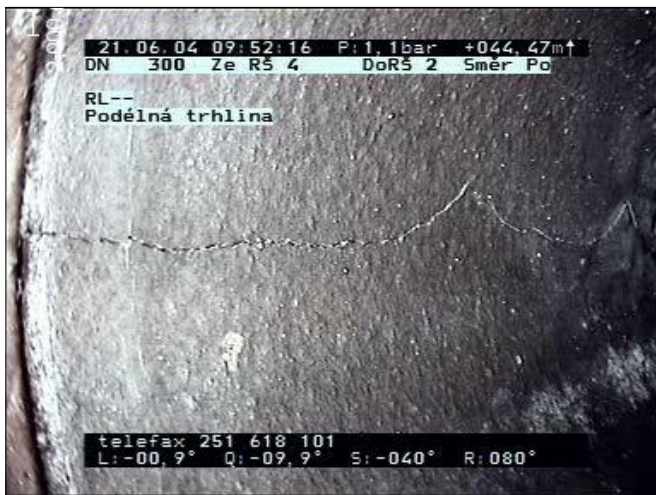
Obr. 14 44,5 m Podélná trhlina
