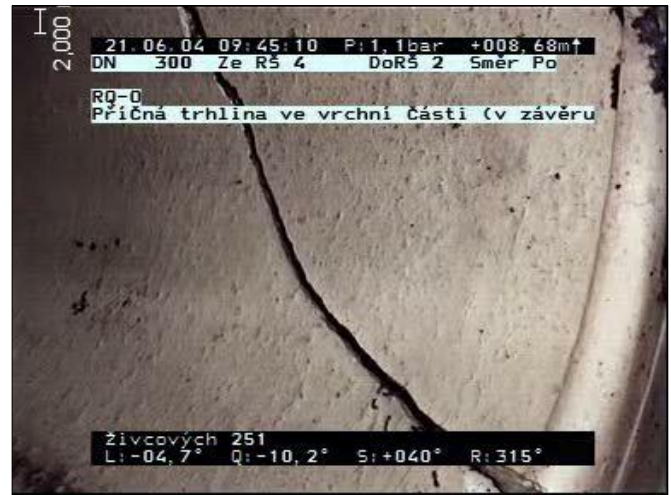
Obr. 13 8,7 m Příčná trhlina ve vrchní části (v závěru)
