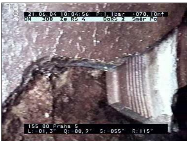
Obr. 16 70,1 m Chybějící část stěny
